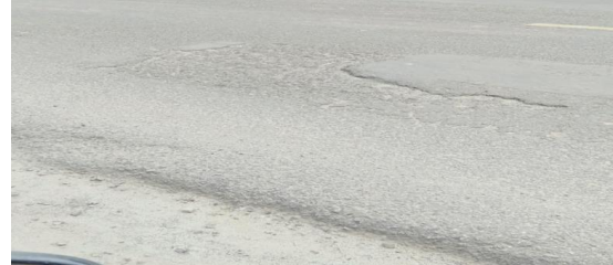
Gambar 1. Kerusakan Pelepasan Butir
